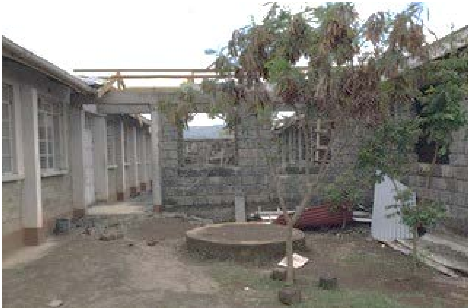
Links: Das fertige Mädchen-Speisesaal-Gebäude Rechts: Der Rohbau des Jungen-Speisesaal-Gebäudes Im Hintergrund: Gästehaus im Bau
