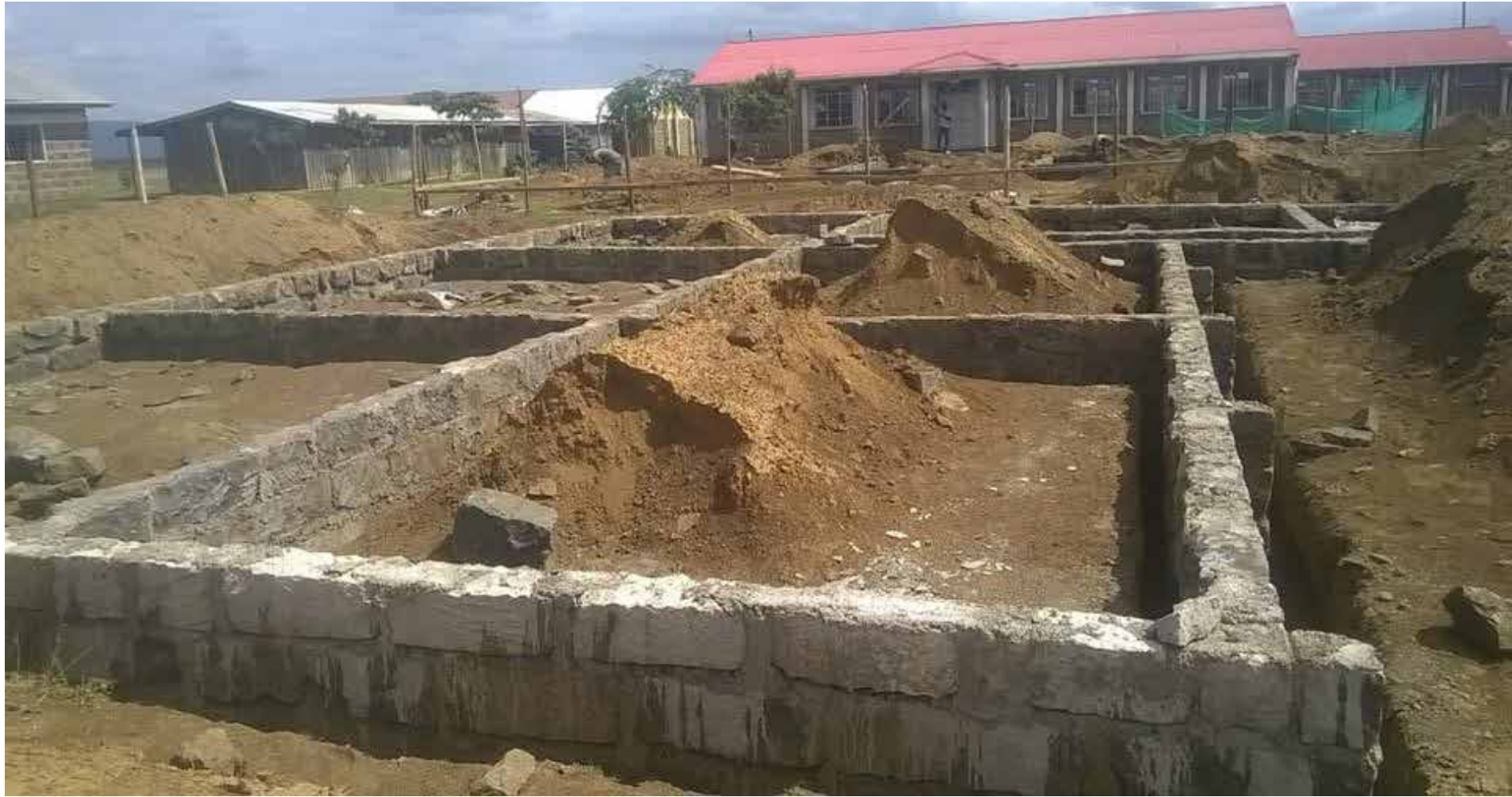
Fundamente und Grundmauern für Jungen-Speisesaal und 3 Gaste-Unterkünfte mit Nassräumen (1) Im Hintergrund: Fertiger Speisesaal für die Mädchen mit Küche
